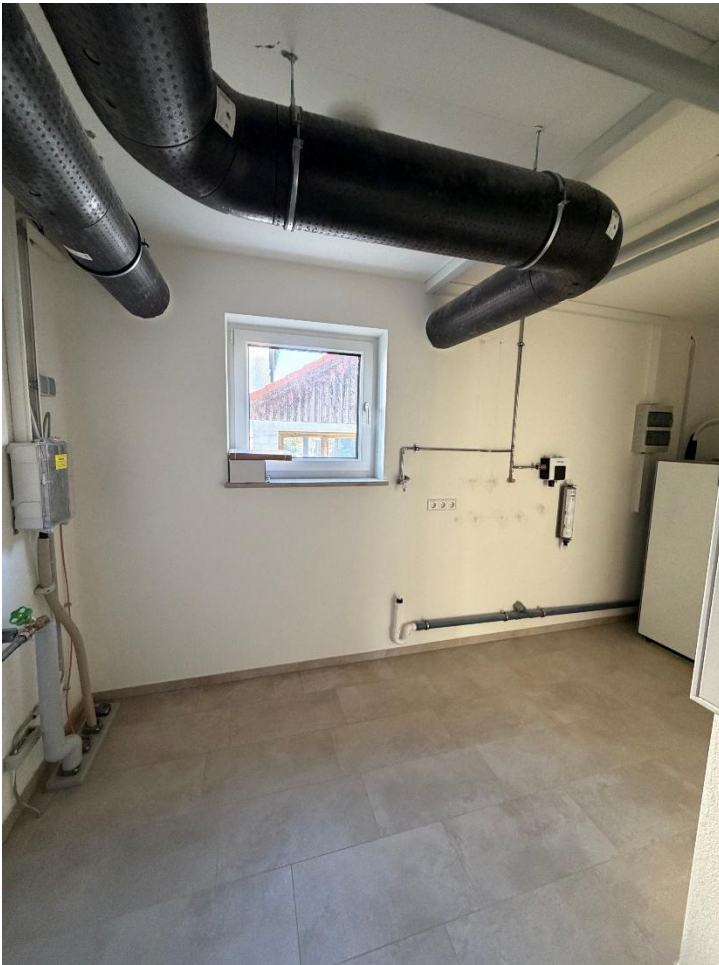
Haustechnik und Hauswirtschaft
